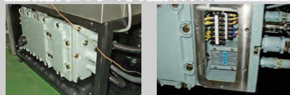
防爆冷蔵庫（EPシリーズ）の制御ボックス（耐圧防爆構造）
